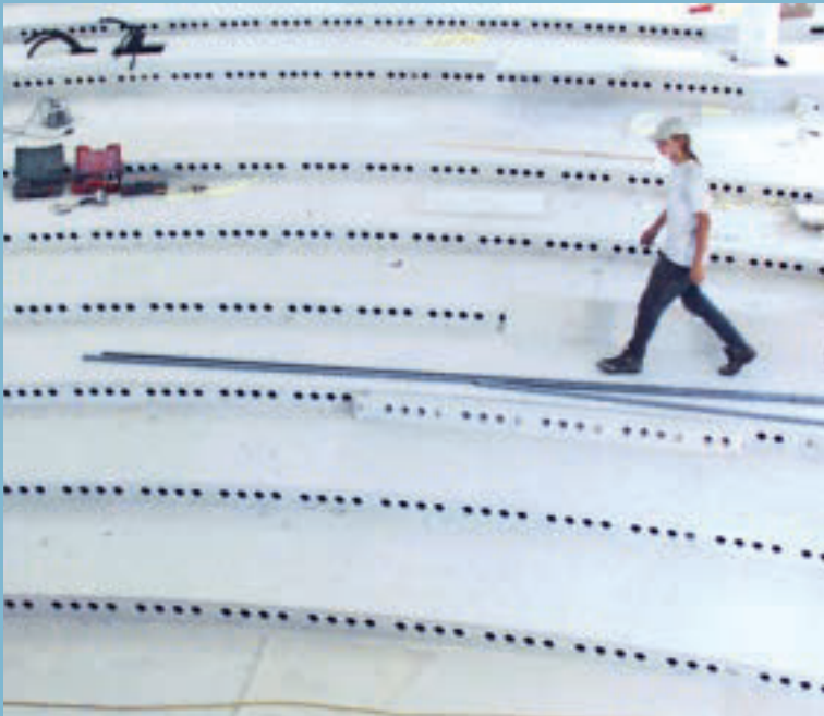
Einbau eines GIFAFloor LBS Systems in einen Konzertsaal mit Zulufführung.
