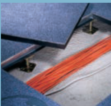
Komfortabler Zugriff auf Installationen durch Revisionsöffnungen.
